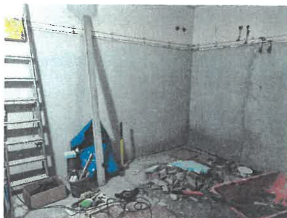
Foto n.º 4: Requalificação I.S. (antes)
