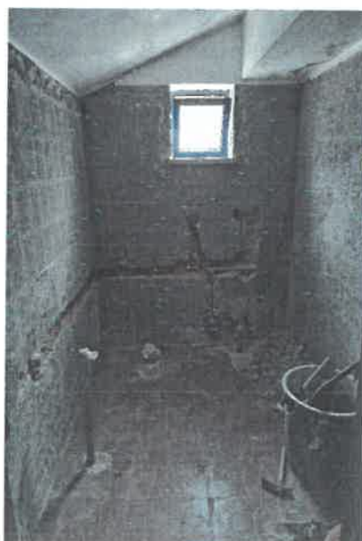
Foto n.º 6: Requalificação I.S. (antes)
