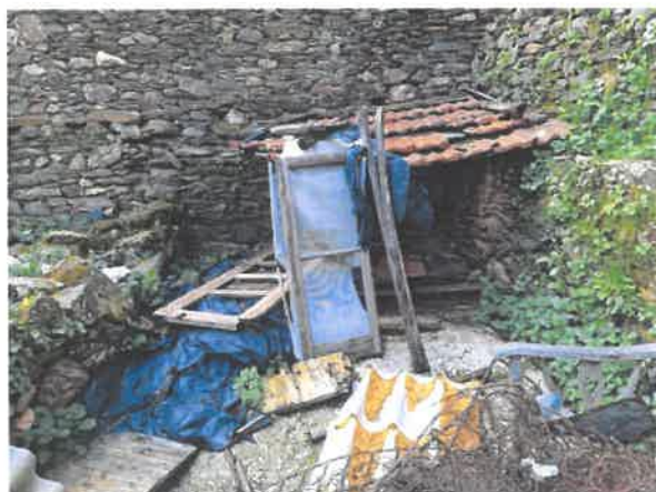
VISTA GERAL DO EDIFÍCIO EM RUÍNAS
