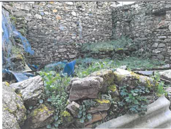
VISTA GERAL DO EDIFÍCIO EM RUÍNAS
