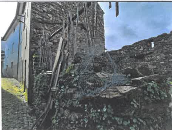
VISTA GERAL DO EDIFÍCIO EM RUÍNAS
