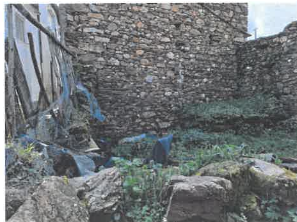
VISTA GERAL DO EDIFÍCIO EM RUÍNAS
