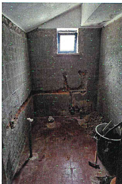
Foto n.º 6: Requalificação I.S. (antes)
