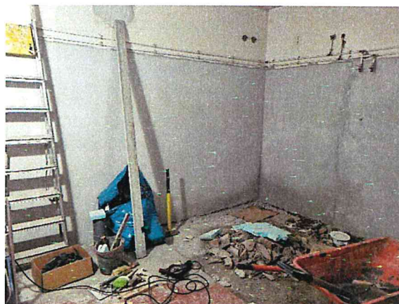
Foto n.º 4: Requalificação I.S. (antes)
